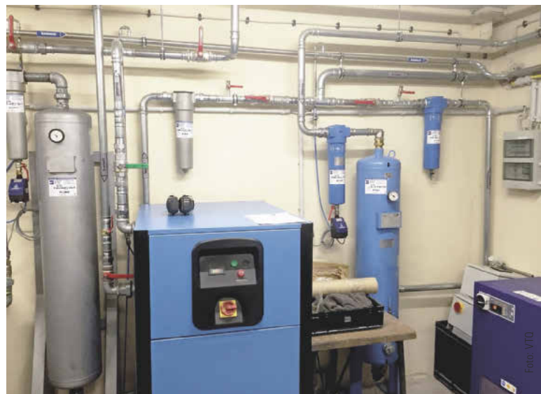
Die Druckluftaufbereitung – Vier moderne Kompressoren erzeugen gemeinsam mit den Stickstoffgeneratoren flexibel bis zu 100\text{ m}^3 Stickstoff pro Stunde.
